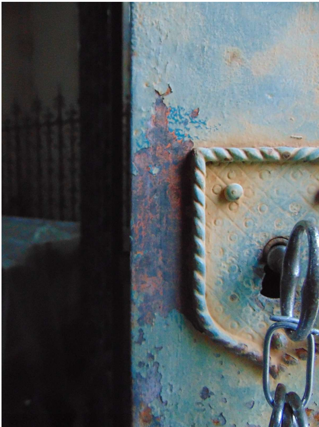
Fot. 1 Montresor. Mauzoleum Branickich. Fragment drzwi do mauzoleum. XIX wiek. Widoczne poszczególne nawarstwienia, produkty korozji metalu oraz łuszczące się warstwy przemalowań.
